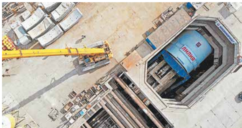
Строительство двухпутного тоннеля метро на участке «Карамышевская» — «Мневники» БКЛ: старт щита-гиганта «Лилия»
