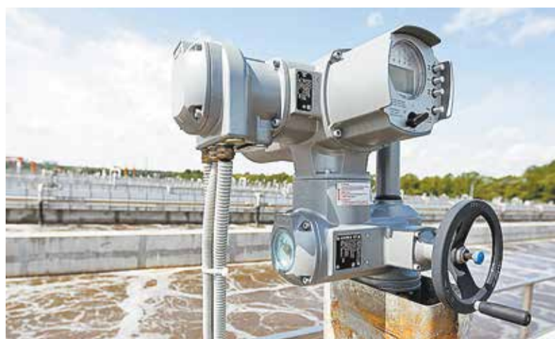
Ново-Курьяновские очистные сооружения
