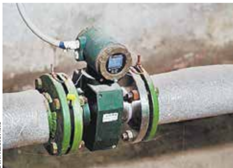
Система контроля за использованием коммунальных ресурсов, установленная в детском саду №10 «Сказка» (Железноводск)
