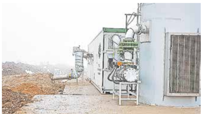
На полигоне создана система сбора и сжигания свалочного газа
