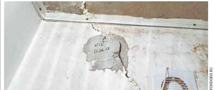
Во время осмотра дома № 114 по улице Новоселов (Пенза) была обнаружена трещина на стене шириной более 5 мм (дом был включен в реестр обращений по вопросам качества жилых помещений)
