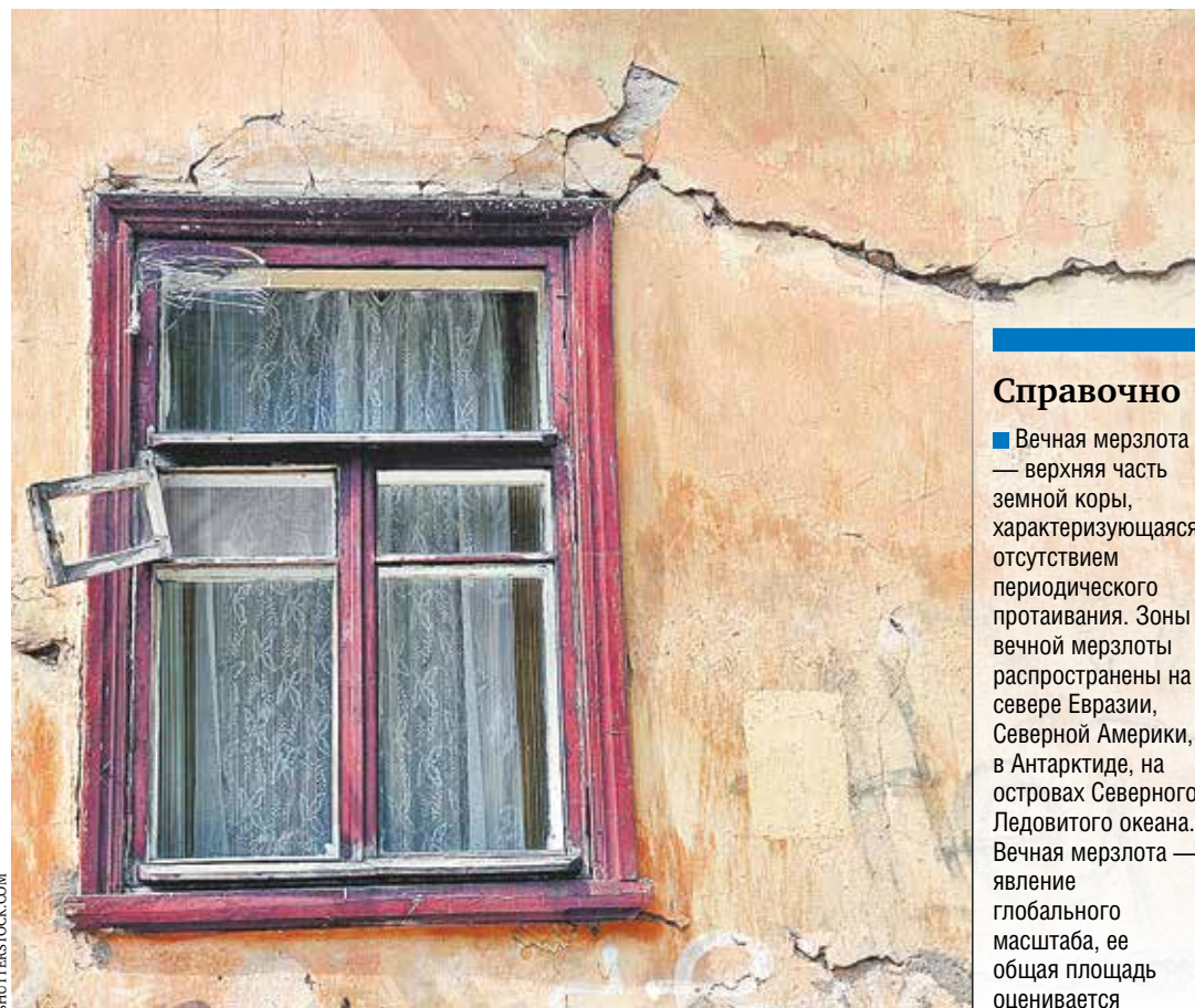
Таяние вечной мерзлоты приводит к деформации и разрушению зданий и сооружений в районах Крайнего Севера и Сибири
