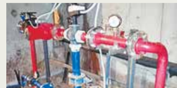
В Клину в доме № 62, корп. 2 по улице Чайковского установили автоматизированный узел управления системой отопления
