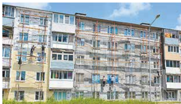
Теплоизоляция стен — одно из наиболее популярных решений, позволяющих добиться экономии энергоресурсов
