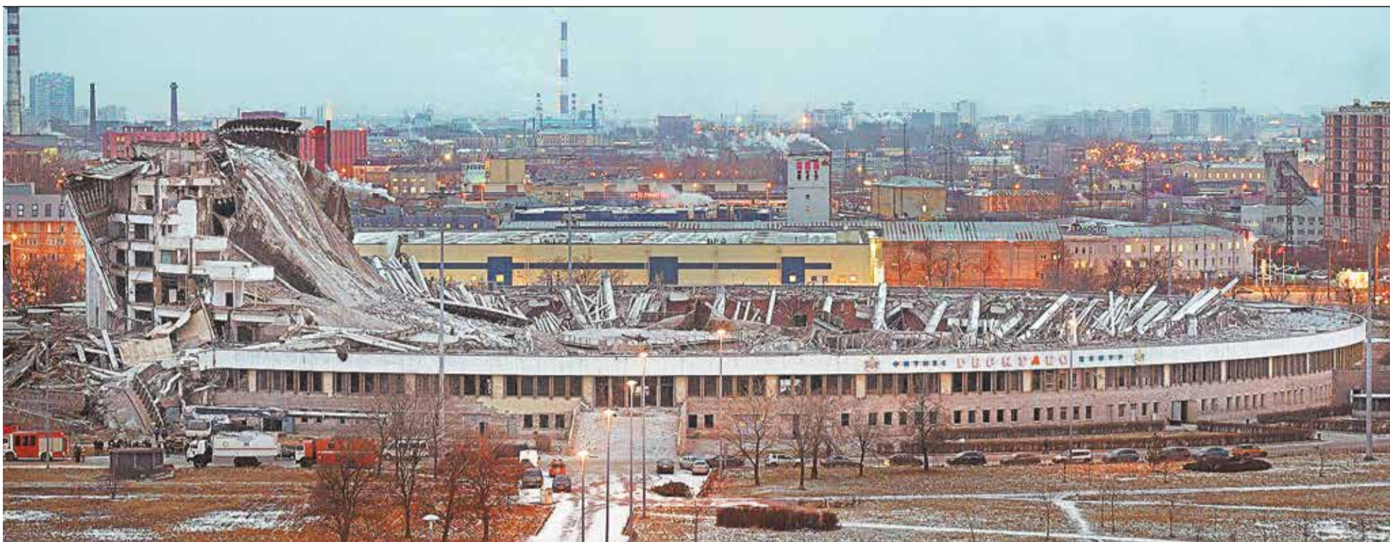
Так выглядело здание СКК «Петербургский» после обвала крыши
