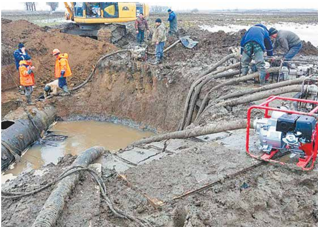
Работы по устранению аварии на магистральном водоводе Троицкого группового водопровода (Краснодарский край)
