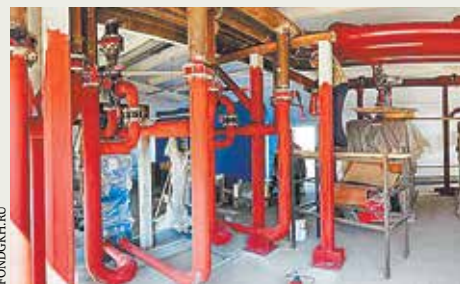
Котельная №2 в городе Черепанове
