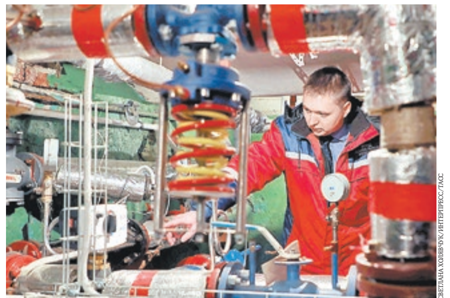
Сотрудник фонда капитального ремонта Санкт-Петербурга во время проверки индивидуального теплового пункта с автоматизированной системой погодного регулирования в одном из жилых домов
