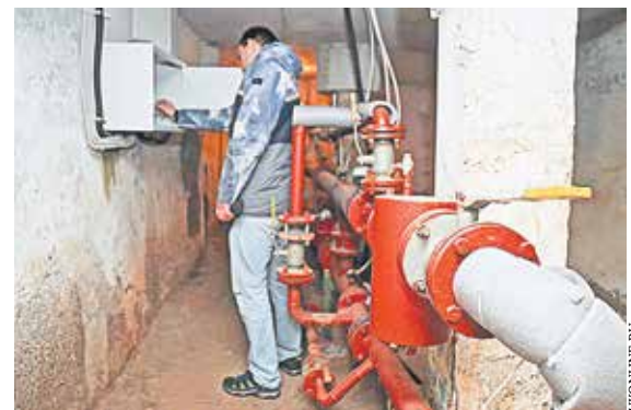
Автоматизированная система отопления в одном из жилых домов Самары, которая позволяет экономить около 20% энергоресурсов
