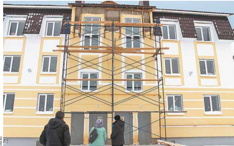
Активисты Костромского отделения ОНФ во время выездной проверки домов, строящихся по программе переселения из аварийного жилья
