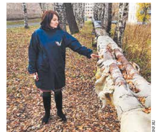
Эксперт ОНФ проверяет изоляцию на теплотрассе в Республике Коми
