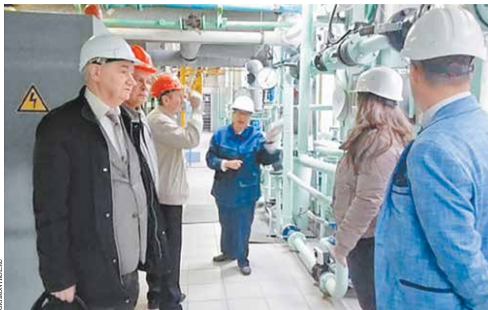
Эксперты «ЖКХ Контроля» проверили котельную в Вологде после жалобы жителей
