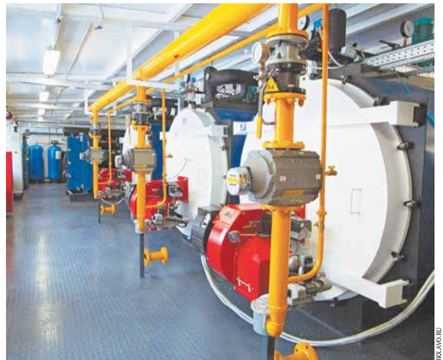
Новая блочно-модульная котельная, открытая в Киржаче (Владимирская область)
