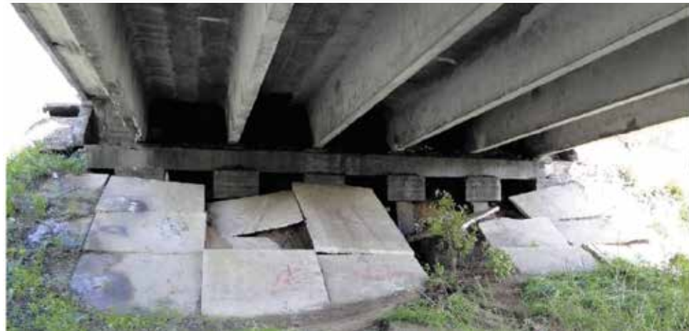
Рис. 3. Мост до ремонта
