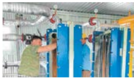
Подготовка к отопительному сезону новой котельной в поселке Целина Ростовской области
