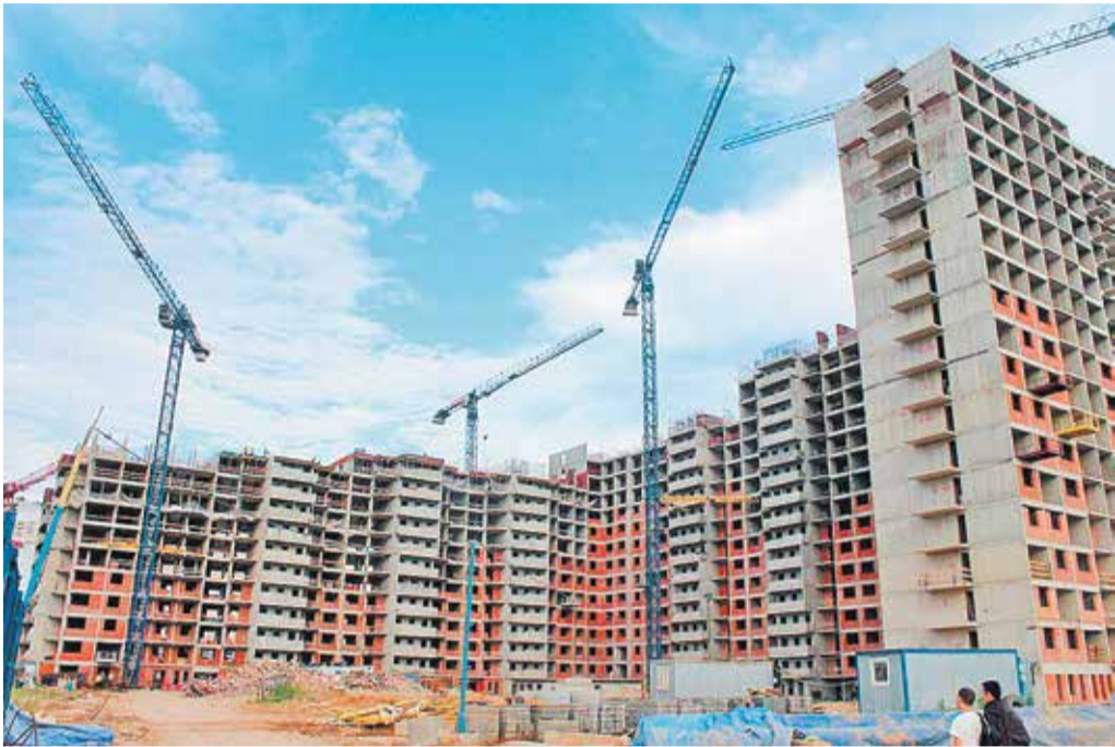
Недостроенные корпуса ЖК «Царицыно» (вторая очередь)
