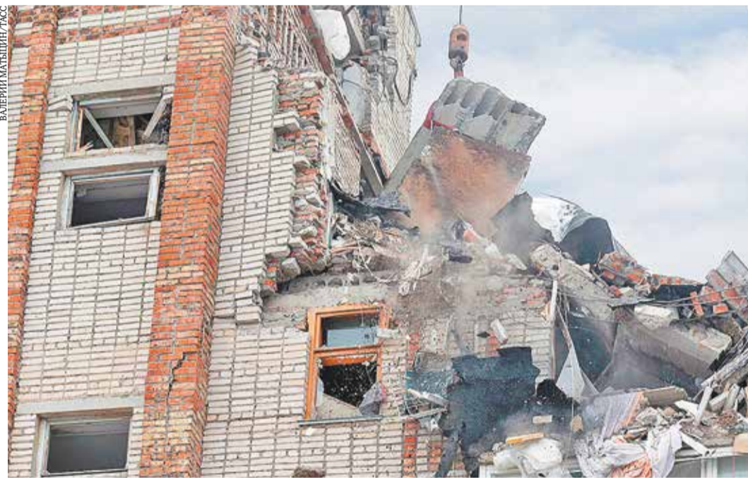
Взрыв бытового газа в жилом доме в Шахтах унес жизни пяти человек
