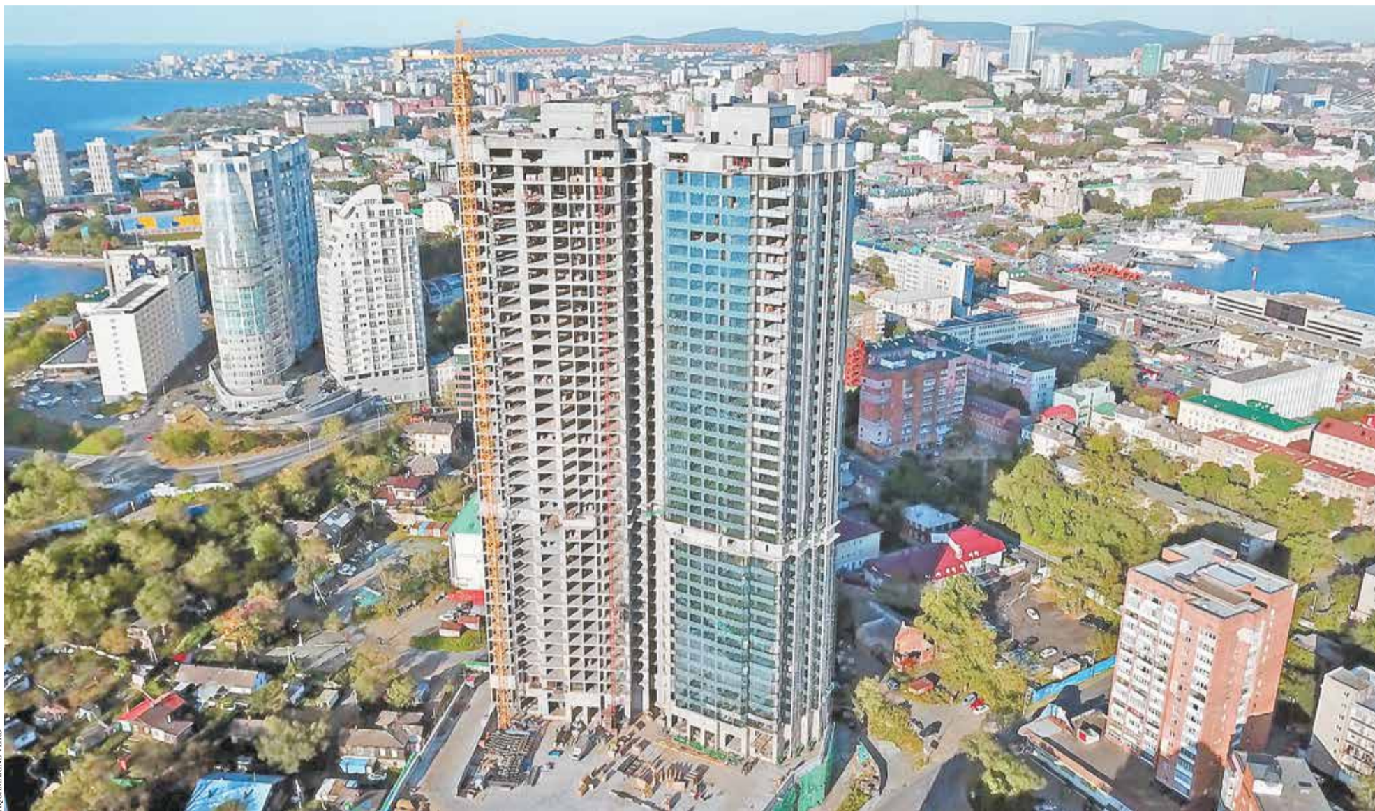
Самое высокое из строящихся в Приморском крае жилых зданий — 41-этажный дом в ЖК «Аквамарин» во Владивостоке
