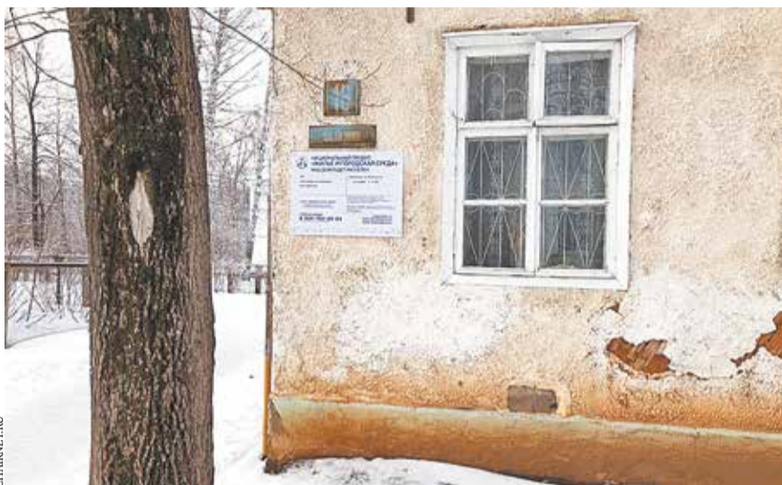
Аварийный дом под расселение в городе Чайковском (Пермский край)
