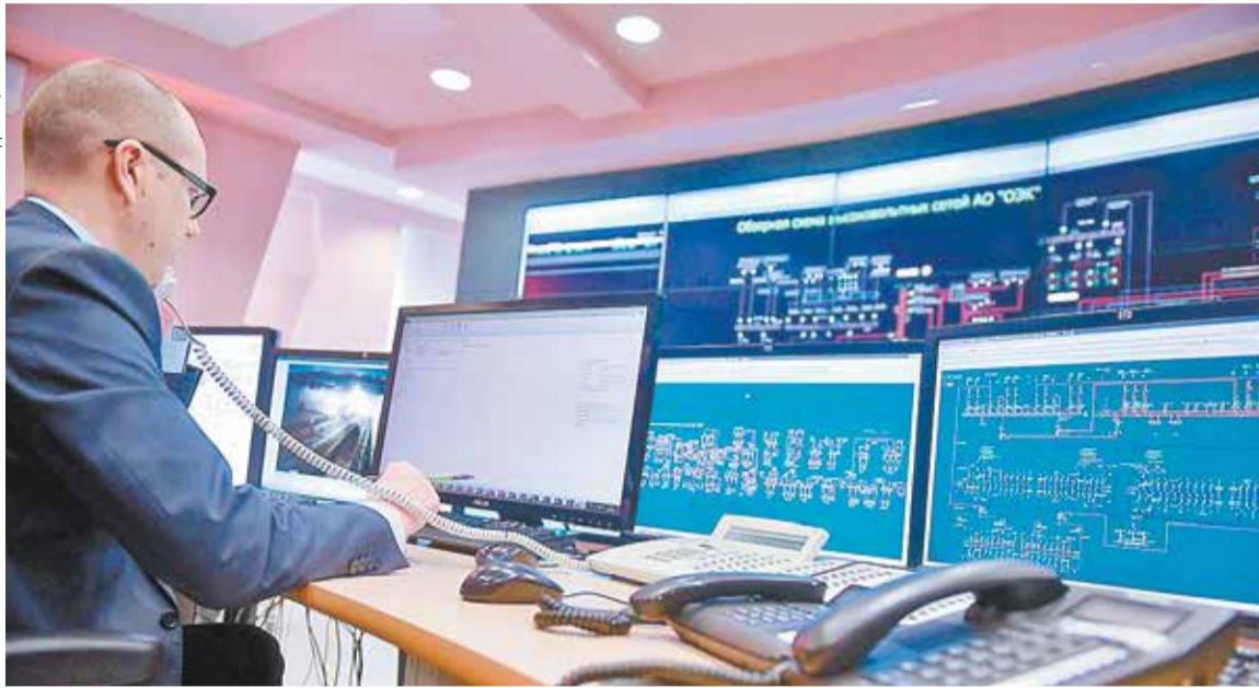
Пульт управления подстанции «Абрамово» электросетевой компании АО «ОЭК»
