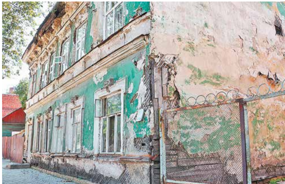
Аварийный дом на улице Богдана Хмельницкого в Иркутске
