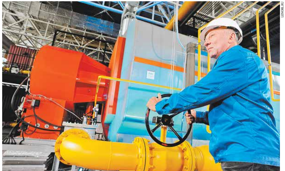
Газовая котельная в Тихвине — первый такой объект в Ленинградской области, построенный в рамках концессионного соглашения
