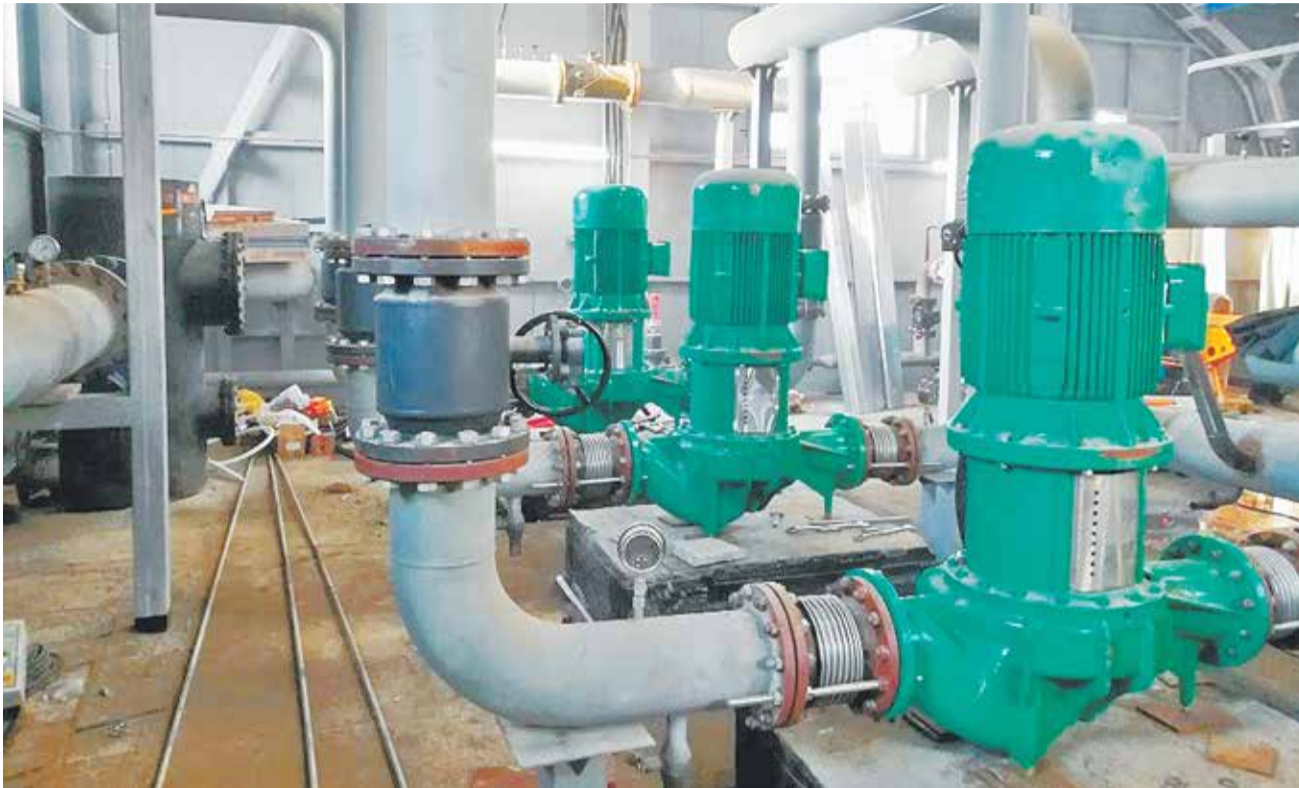
Технологические трубопроводы и оборудование бойлерной в поселке Чегдомын (Хабаровский край). В 2017-2018 годах здесь при поддержке Фонда ЖКХ была обновлена система теплоснабжения
