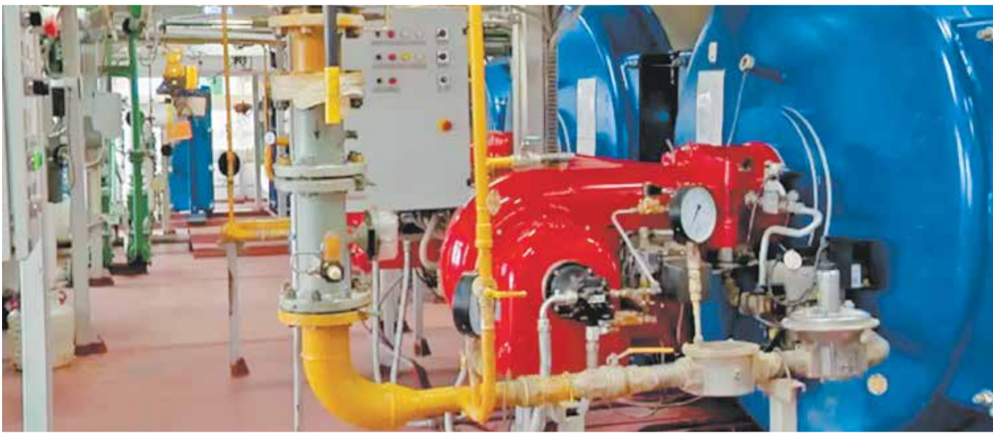
Котельный зал МК-2
