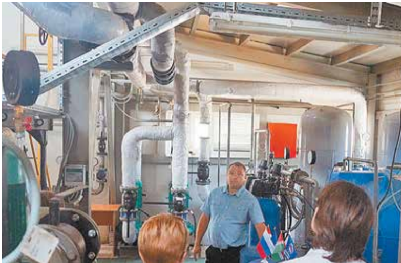
Котельная на биотопливе в Думиничском районе Калужской области
