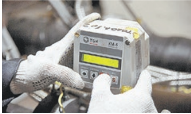
Общедомовой счетчик учета тепловой энергии
