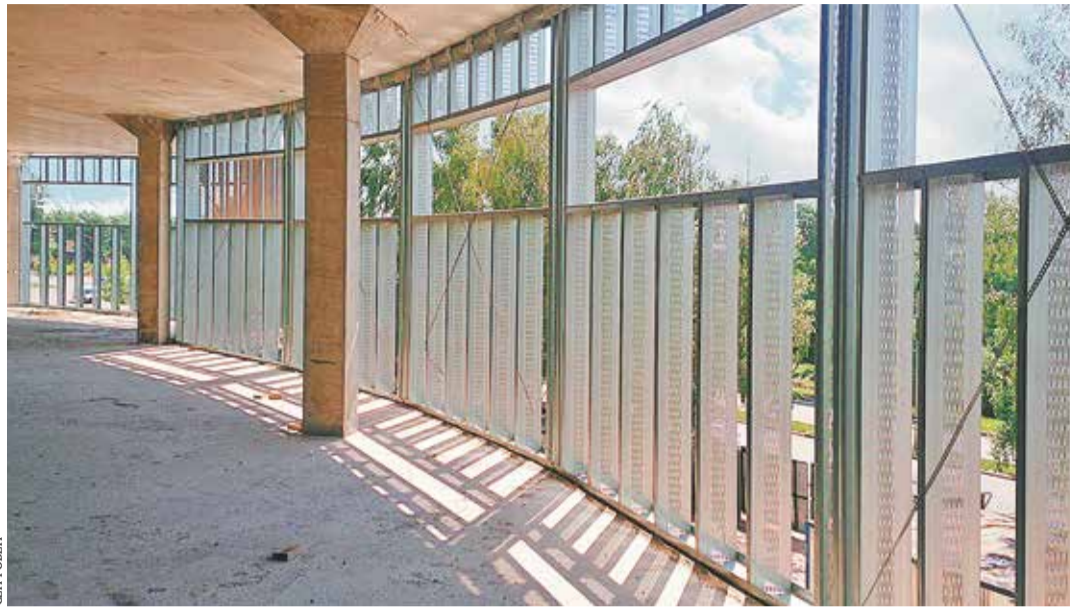
Основа модульного каркасного фасада — легкая стальная тонкостенная конструкция (ЛСТК), на нее крепятся панели из минерального утеплителя
