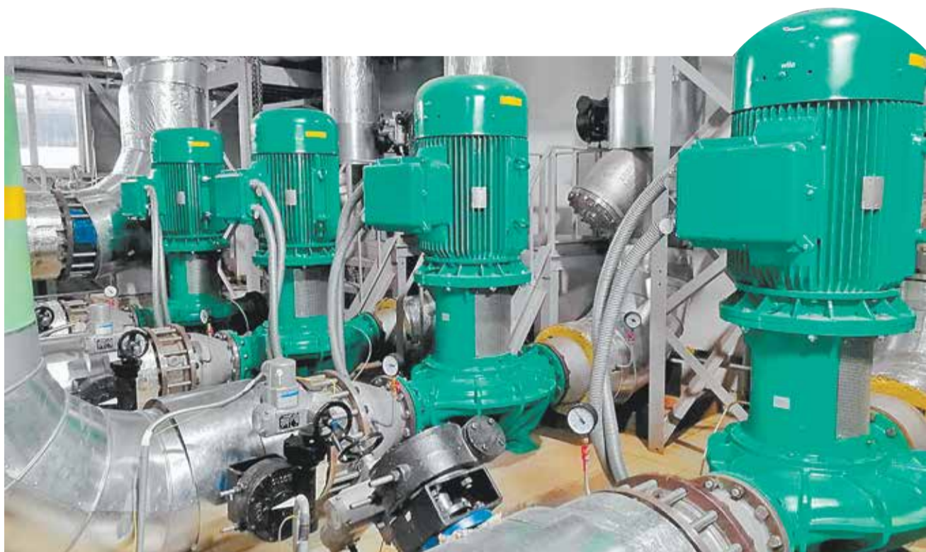
Головной участок отопительной котельной, насосная группа
