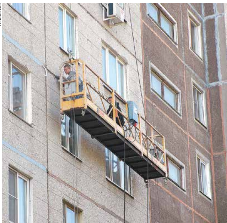
Утепление и герметизация межпанельных швов в доме №38 по набережной Авиастроителей (Воронеж) позволит сократить теплопотери
