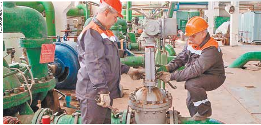
Котельная № 40 обслуживает более двухсот объектов в Центральном районе Волгограда
